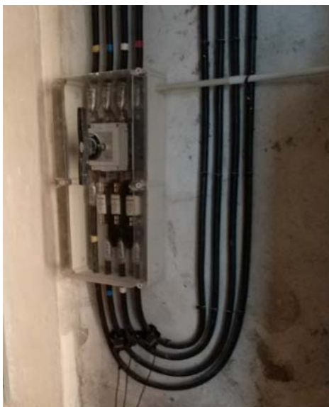
Imagen 16. Interruptor de salida del transformador
