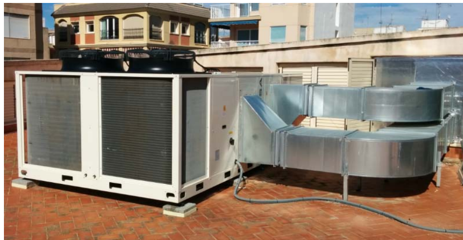
Imagen 13. Equipo de climatización Roof-Top
